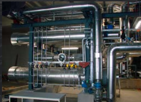
Sous-station Eau Surchauffée MOUTON DUVERNET (Quartier Part-Dieu – Ville de Lyon)
